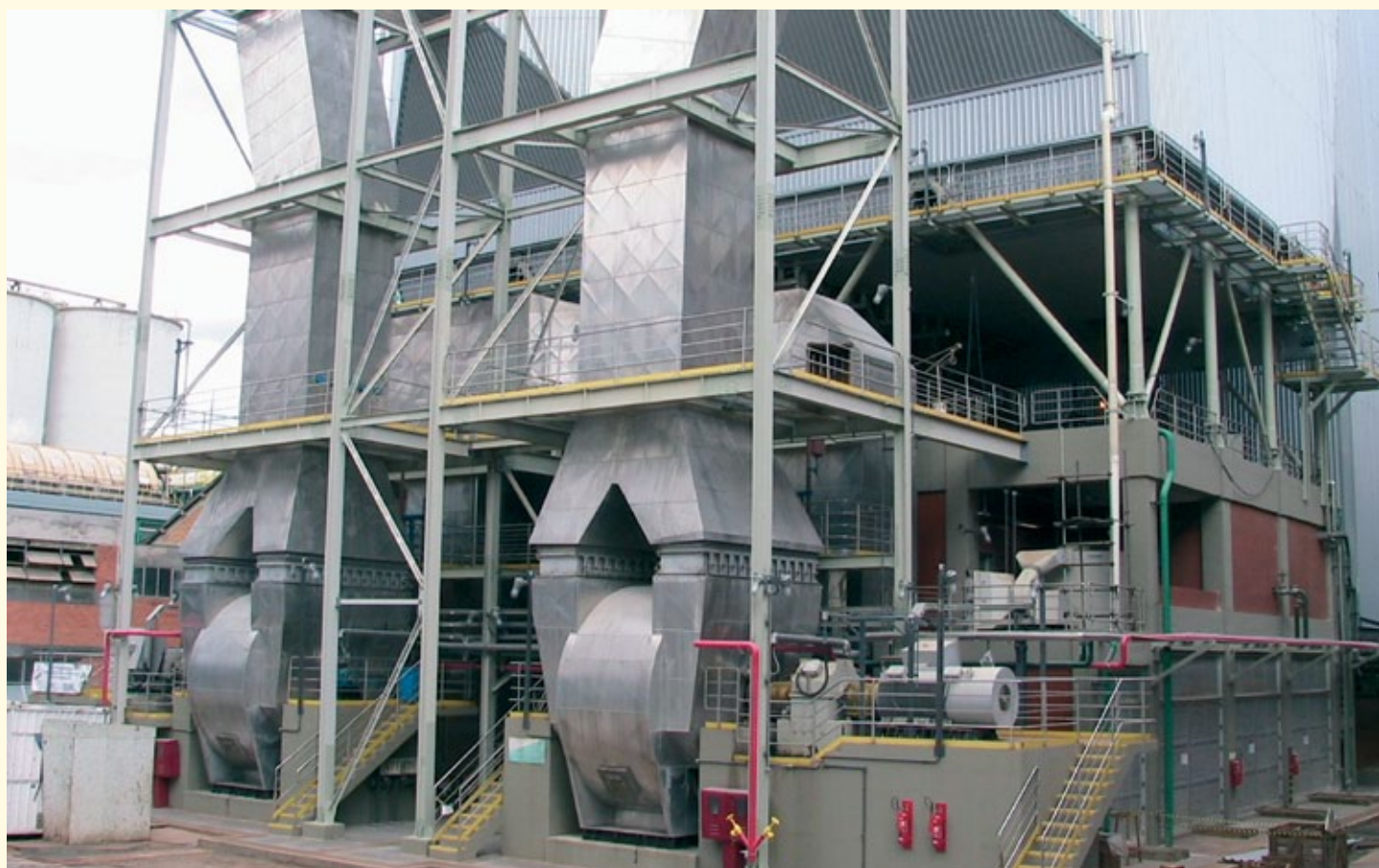
2x34 KSL, 2000 кВт - 1200 об/мин. Привод вентилятора (Бразилия)
